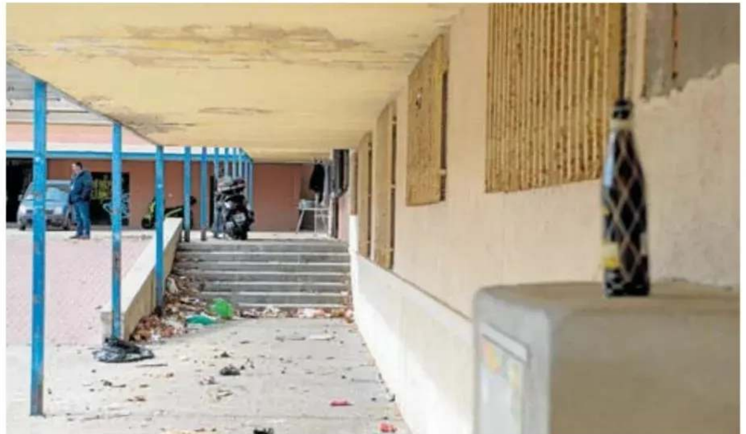
La suciedad se acumula en una zona interbloque de San Blas, en 2022. Belén Díaz
